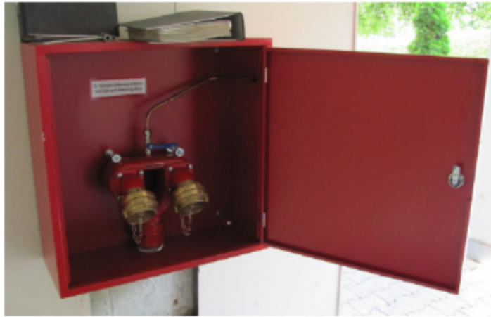
Abbildung 5: Einspeisestelle mit Schutzschrank für Löschwasseranlagen „trocken“.
