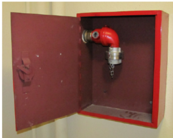
Abbildung 6: Entnahmestelle mit Schutzschrank für Löschwasseranlagen „trocken“.
